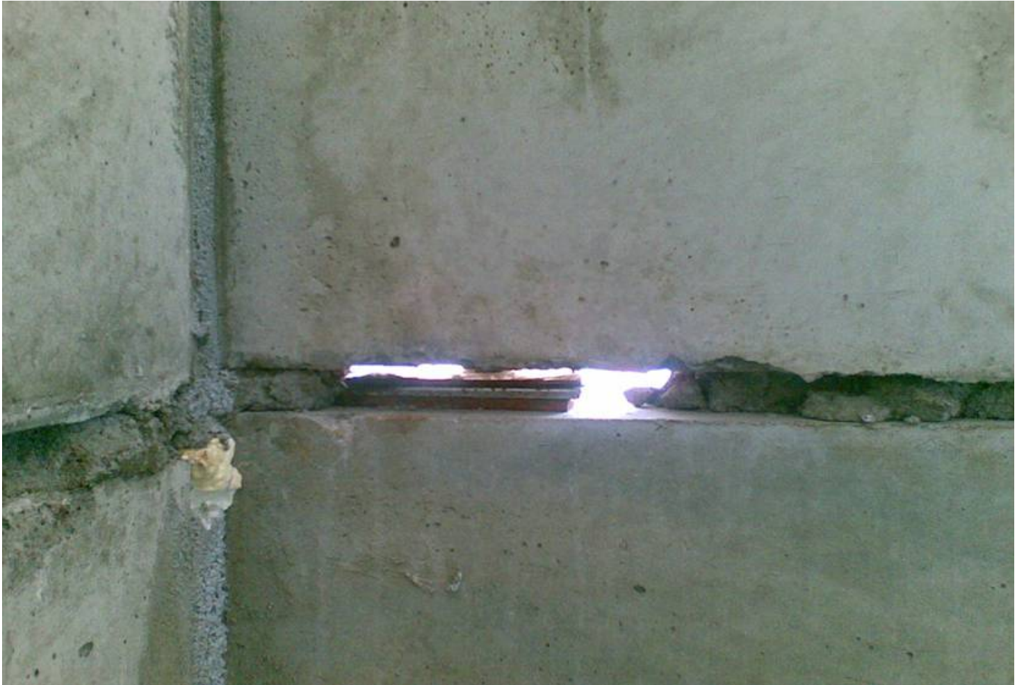
Puutteellisesti täytetty vaakasauma. Kuvat Timo Rautanen
