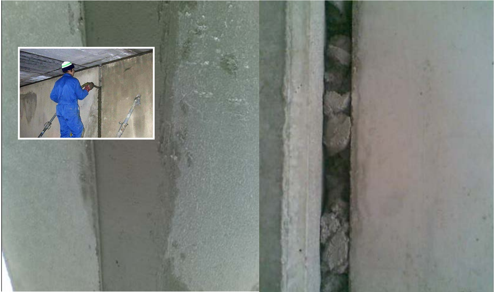
Puutteellisesti täytetty pystysauma. Kuvat Timo Rautanen
