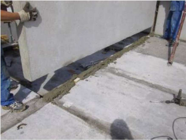
Asennuspalojen viereen jää helposti aukkoja. Kuva Timo Rautanen
