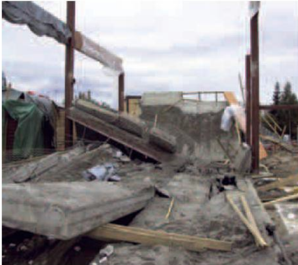
Pudonnut ontelolaattakenttä. Lankut ontelolaattojen alla ovat pelastustoimien jäljiltä.
