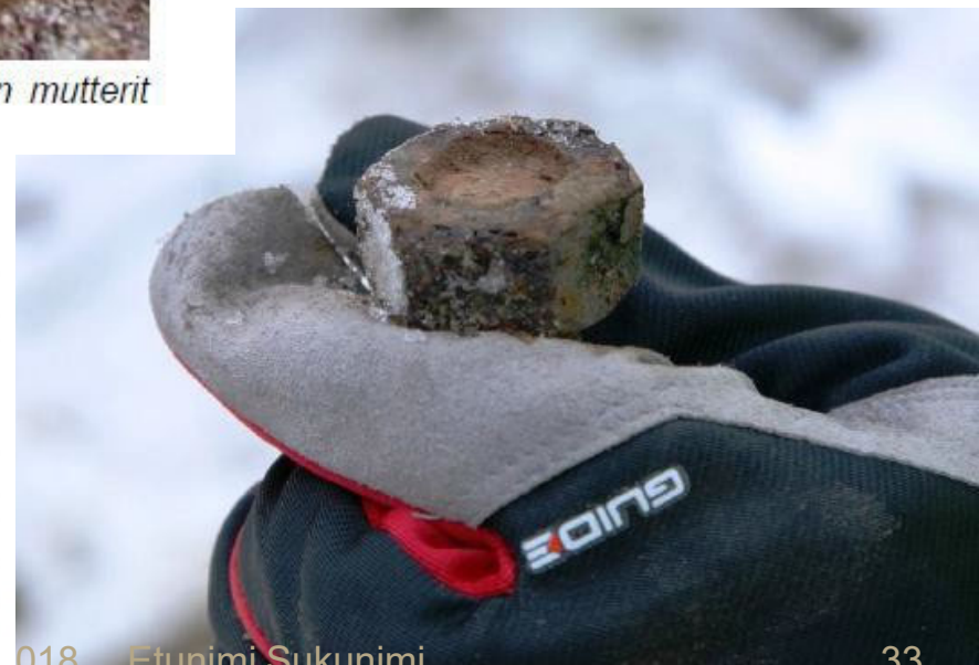
Kuva 6. Riittämätön peruspultin tunkeuma mutteriin nähden.
