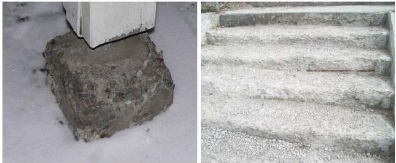
Kuva 4.5.1. Vasemmalla pakkasrapautunut betoniantura ja oikealla pakkas-suolarapautuneet betonirappuset (kuvat Risto Mannonen).
