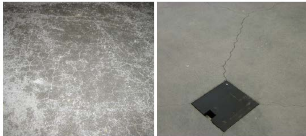
Kuva 4.1.3. Plastisesta kutistumasta (vasemmalla) ja kuivumiskutistumasta (oikealla) aiheutunutta betonilattian halkeilua (kuvat Pentti Lumme).
