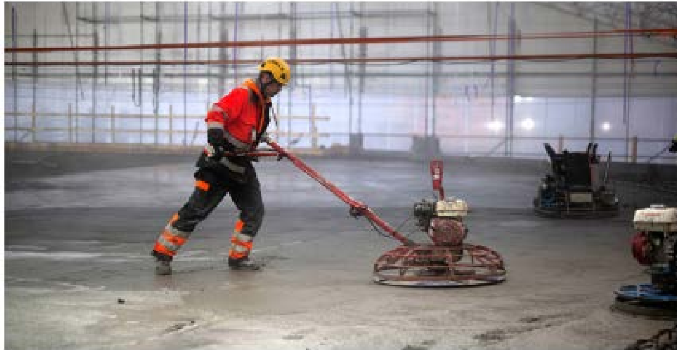
Kuva 3.17. Pinnan tiivistykseen ja lujittamiseen käytetään hiertokoneita (edessä käsin ohjattava ja taustalla päältä istuttava).
