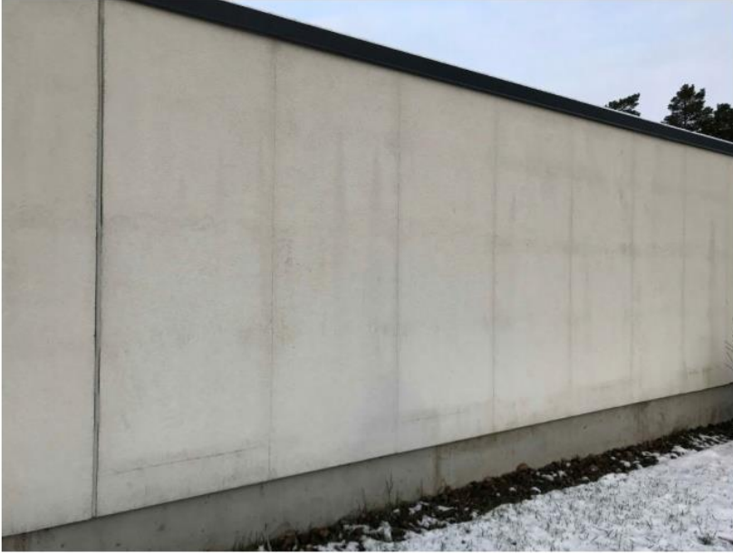
Kuva 4.29 Levyrapausjärjestelmän saumojen sekä vaakarankojen kiinnityspisteiden kohdalla tapahtunutta halkeilua. Kuva: Tampereen yliopisto.
