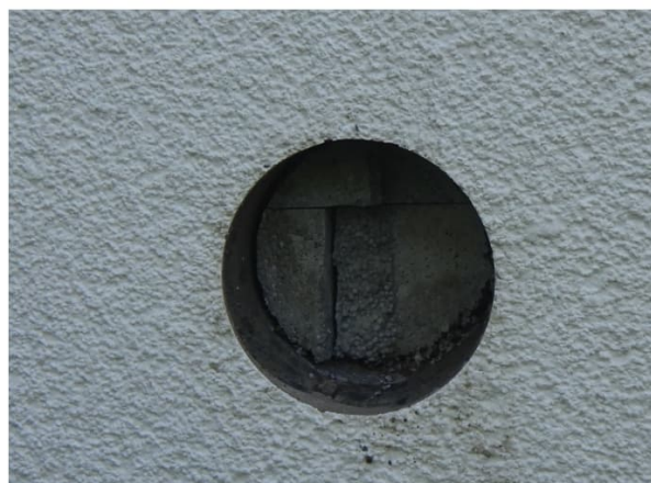
Kuva 7. Myös näytteen HT2 taustalla on kuorikiven vaakasauma, mutta pinnassa ei ole näkyvää halkeamaa tai pullistumaa.
